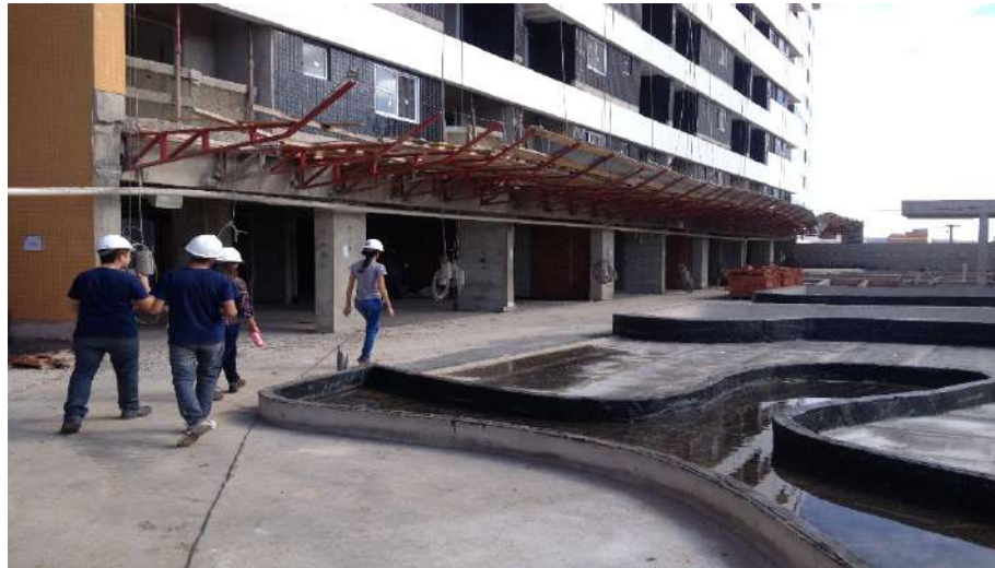
Figura 1 – Primeira visita realizada pelos discentes da disciplina Projeto e Construção de Edifícios II.
